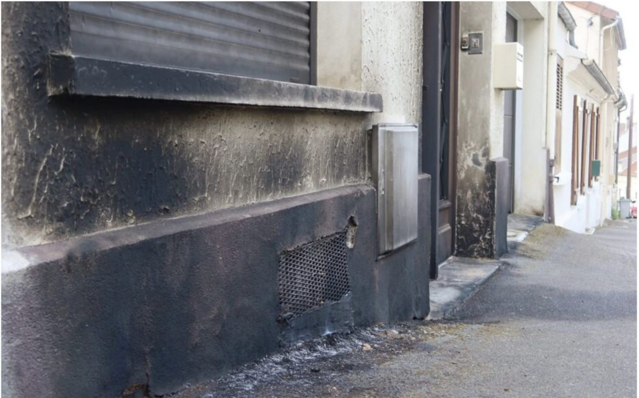
Liancourt, ce mardi 6 mai. Après la tentative d'incendie, à Liancourt, Frédéric Trinh, le procureur de la République de Beauvais, a indiqué qu'«une forte odeur d'essence a été sentie sur cette façade». LP/Florent Heib
