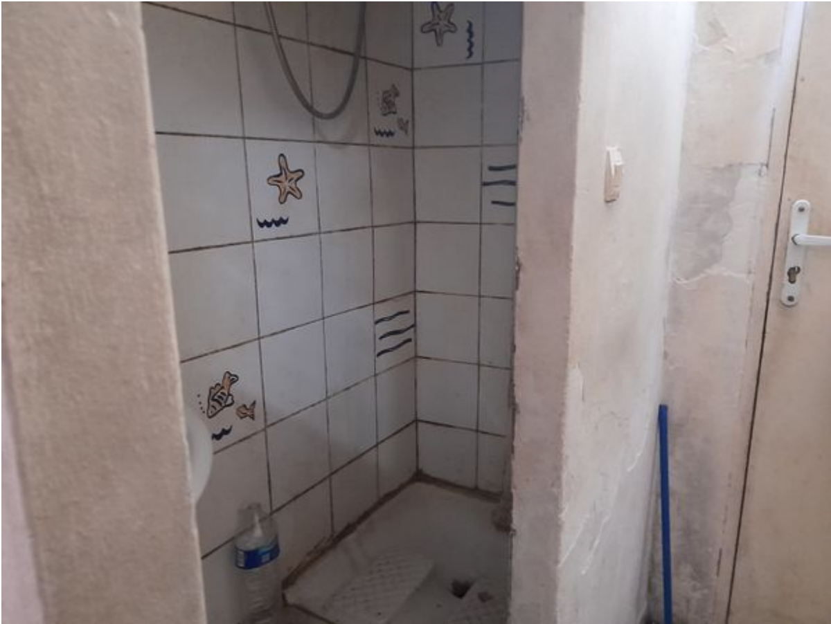
Des toilettes à la turque qui servent aussi de douche dans ce logement de 8M2 © Radio France – Fabien LE DU
