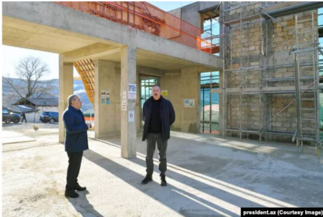
Le président azerbaïdjanais Ilham Aliyev (à droite) visitant le chantier de la mosquée de Dasalti/Karintak en décembre 2023.
