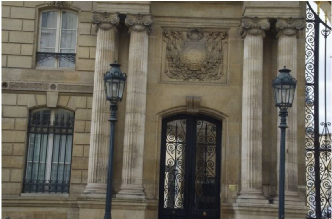
Paris (VIIIe), le 11 avril. Des murs et des colonnes encrassées... À cent jours des JO de Paris, le palais de l'Élysée aurait-il besoin d'un sérieux ravalement de façade ? LP/Alexis Bisson
