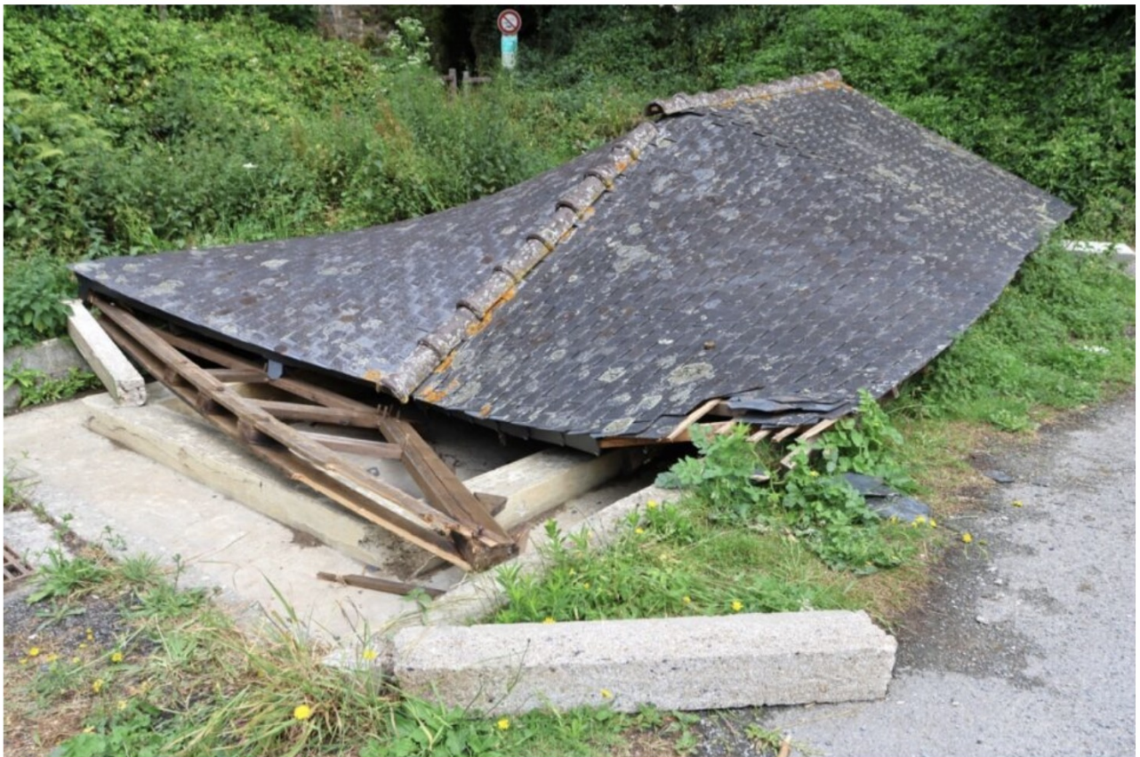
Le toit du lavoir de Montmarin était couché ce lundi 19 juin 2023 à Pleurtuit. ©(Photo Thierry Besnier)
