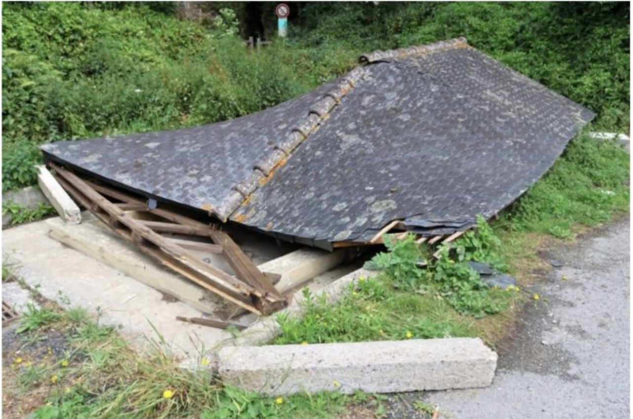
Le toit du lavoir de Montmarin était couché ce lundi 19 juin 2023 à Pleurtuit. ©(Photo Thierry Besnier)
