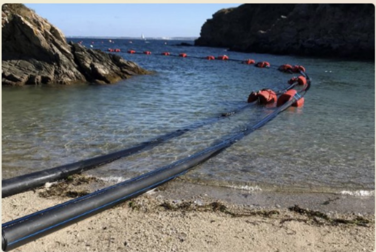
Le pompage de l'eau de mer pour l'usine de dessalement de Groix (août 2022) ● © Romuald Bonnant-France Télévisions
