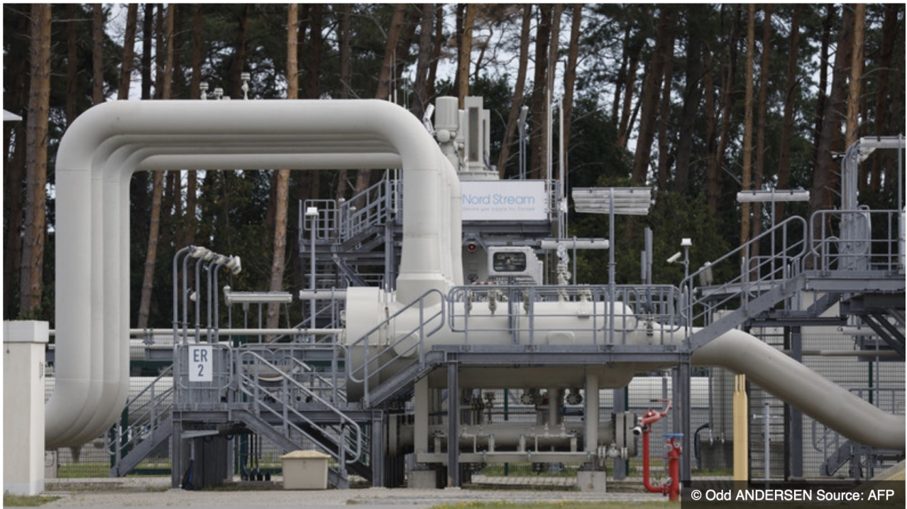
Infrastructures liées au gazoduc Nord Stream 1, à Lubmin, dans le nord-est de l'Allemagne, le 30 août 2022. (Photo d'illustration)
