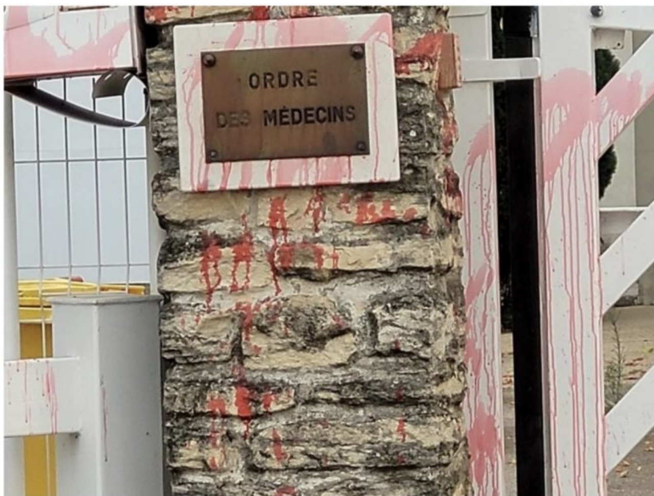
Des traces de peinture rouge sur les façades ont été constatées ce week-end. - DR
